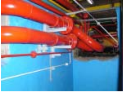
电站冷却水管
